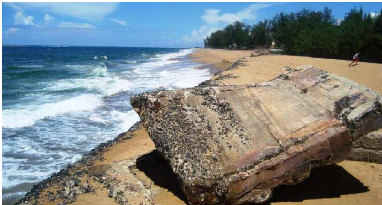
Destruction de la digue de protection à cause de l'érosion marine.
