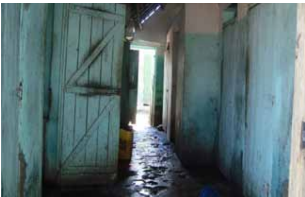
Bloc sanitaire de quartier en mauvais état.
